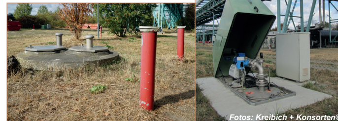
Ökologisches Großprojekt Bitterfeld-Wolfen – Abstromsicherung belasteten Grundwassers durch Brunnenriegel Greppin
