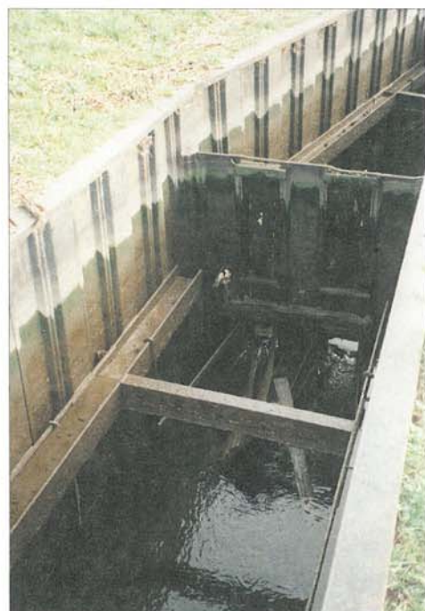
Abb. 10 Desolater Zustand der Wulstfischtrappe
