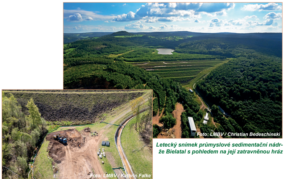
Staveniště zařízení u paty hráze k aktivní úpravě průsakové vody
