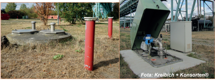
Velký ekologický projekt Bitterfeld-Wolfen – zajištění odtoku znečištěných podzemních vod prostřednictvím bariéry studní Greppin
