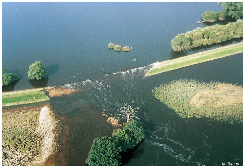
Obr. 4.8-10: Protřzená ochranná hráz u obce Seegrehna pod Wittenbergem/L.
