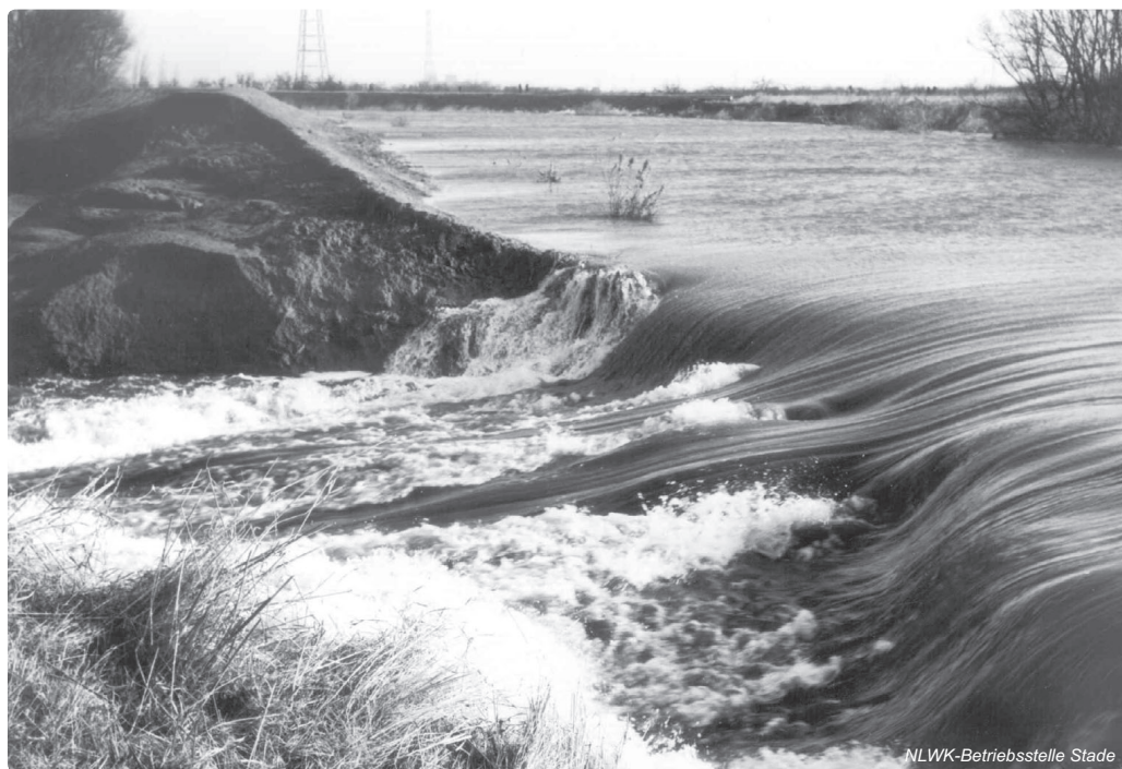
Obr. 3.1-2: Protřzená levá ochranná hráz na toku Schwinge u města Stade během bouřlivého přílivu dne 17. 2. 1962
