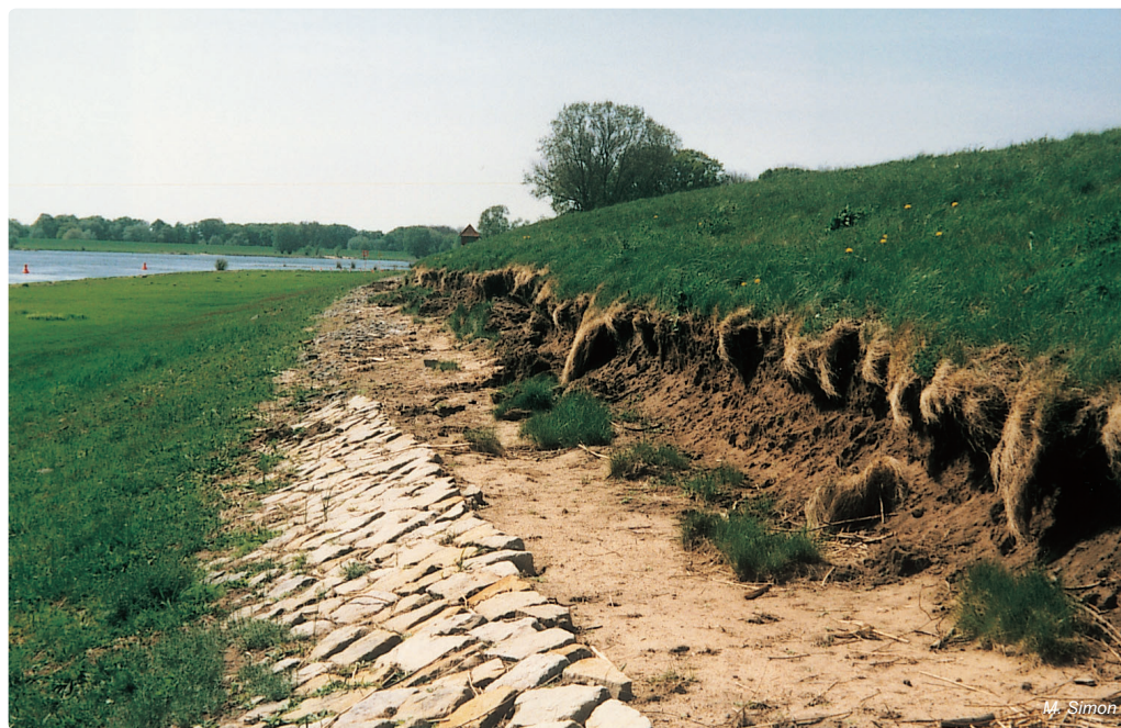
Obr. 5.3-13: Poškození na pravostranné labské hrázi s dlážděným opevněním návodní strany způsobená chodem ledu v lednu 2003 nad obcí Müggendorf (ř. km 464)
