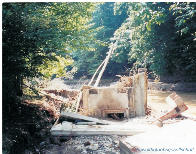
Obr. 5.1-15: Zničená budova vodoměrné stanice Hainsberg 1 na toku Rote Weißeritz ve východní části Krušných hor
