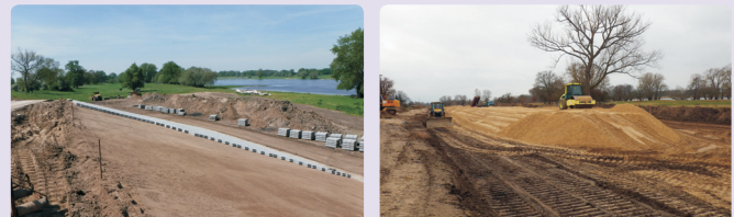
Pokládka betonové dlažby na návorním svahu hráze (vlevo) a stavba pískového jádra při výstavbě nové hráze u obce Vietze (vpravo) – Foto: H. König, NLWKN
