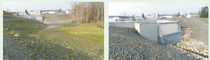
Hráz a retenční prostor (vlevo) a vtokový (škrticí) objekt s česlemi (vpravo) – Foto: město Selb
